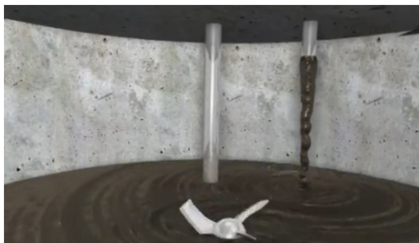
Cisterna de almacenamiento con agitador- mezclador.
