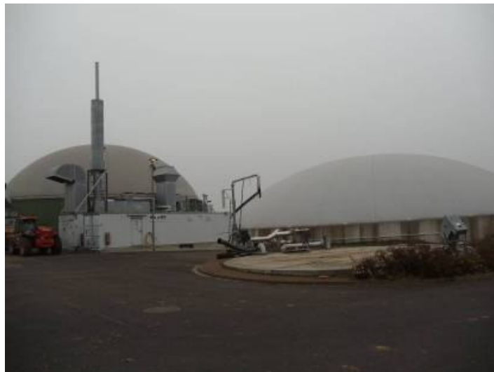
Vista de los dos biodigestores, el depósito de estiércol y, dentro del contenedor, el motor que funciona a metano para generar electricidad para red de agua caliente para calefaccionar las 140 casas del pueblo de Jühnde.
